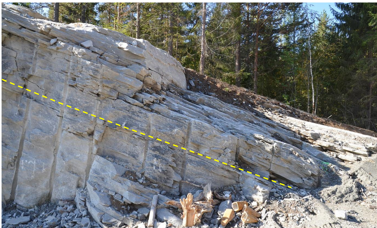
Figur 11: Sørlige avgrensning av øvre sone (over stiplet linje) ved koordinat 925 m i veiprofilet. Under markeringen er bergarten mer grovspaltende (grønn markering i kart i vedlegg). Bilde tatt mot vest.
