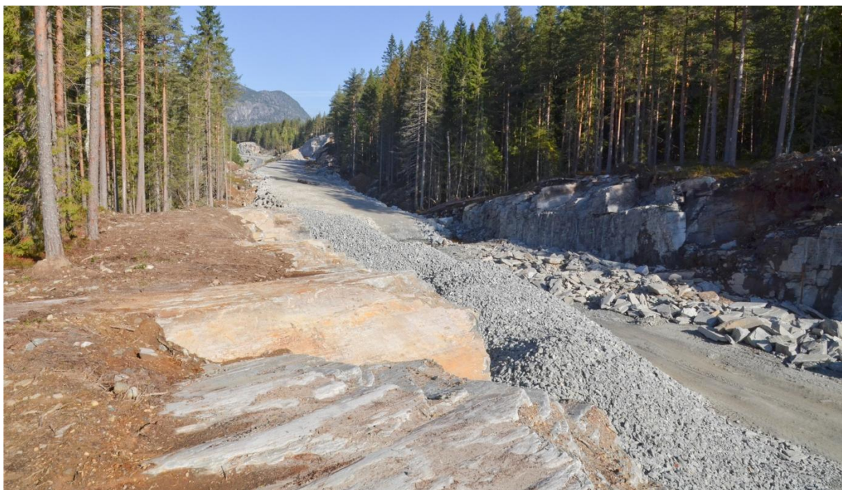
Figur 3: Del av den nye, delvis utsprengte veitraséen for fylkesvei 40 sett mot nord fra koordinat 1050 m i profilet (se vedlegg).
