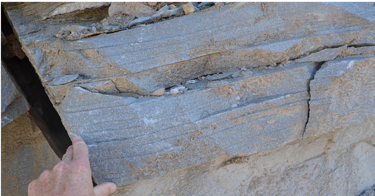
Figur 10: Nærbilde av skjæringen i Figur 9, som viser cm-spalting i skifersonen.
