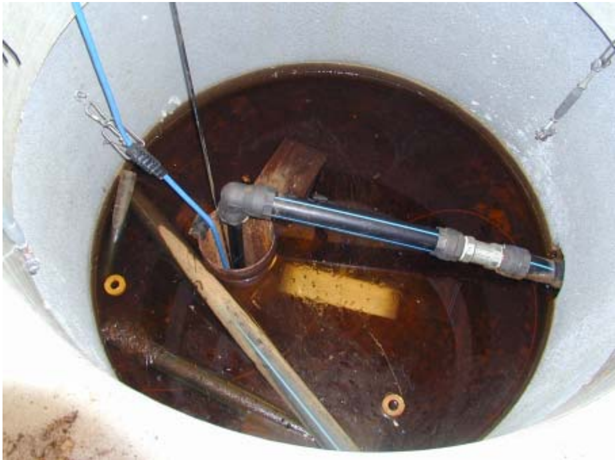
Figur 3.2 Brønn 17 Sørlandet vannverk. Vannet skylles trolig manglende tetting mellom brønnrør og kum og/eller dårlig tetting der slangen går ut av kummen. Bildet er tatt 29. mai 2001.
