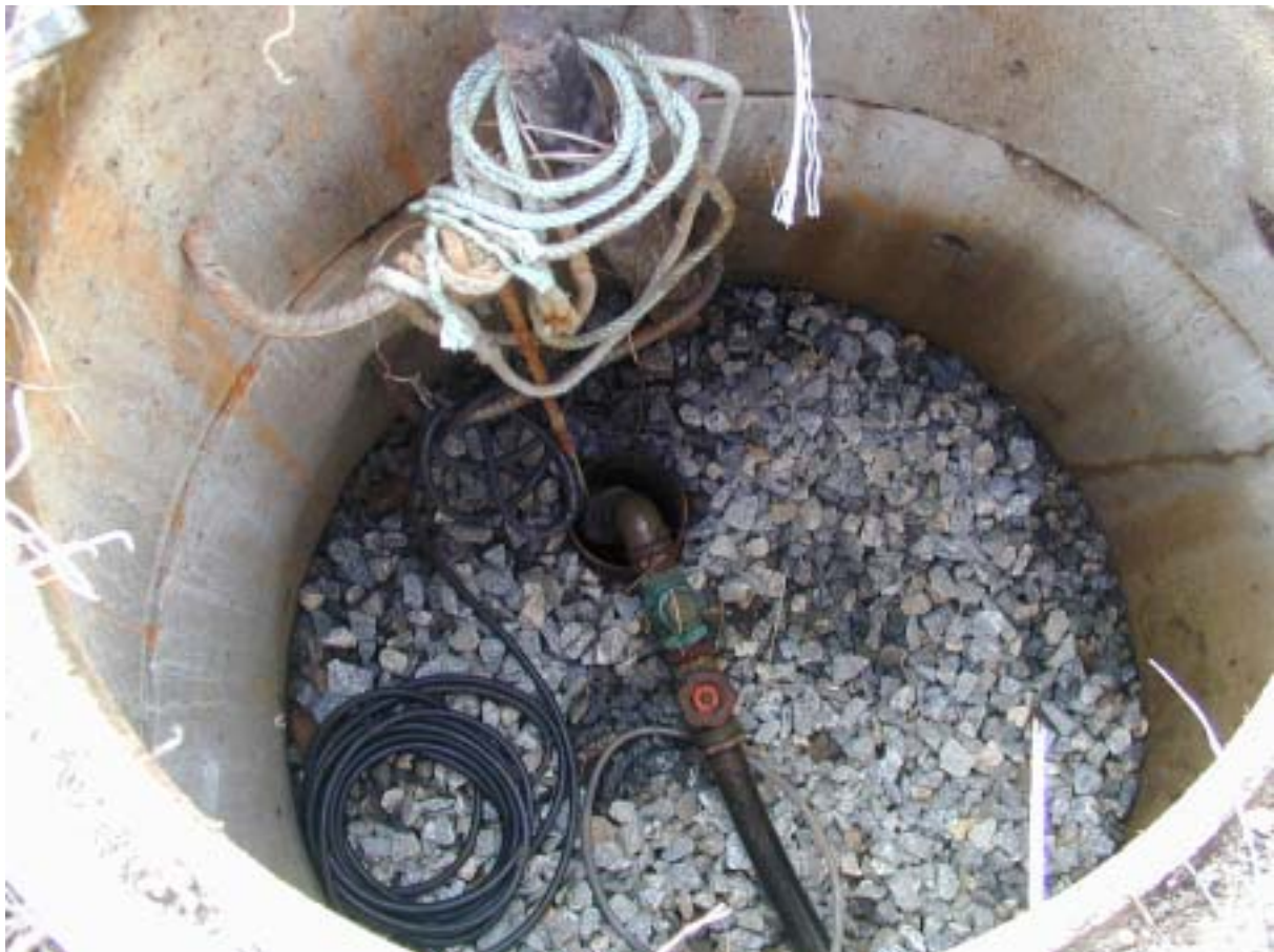
Figur 6.1 Figuren viser grunnvannsbrønnen til Nordlandet vannverk. Bildet tatt 30. mai 2001.
