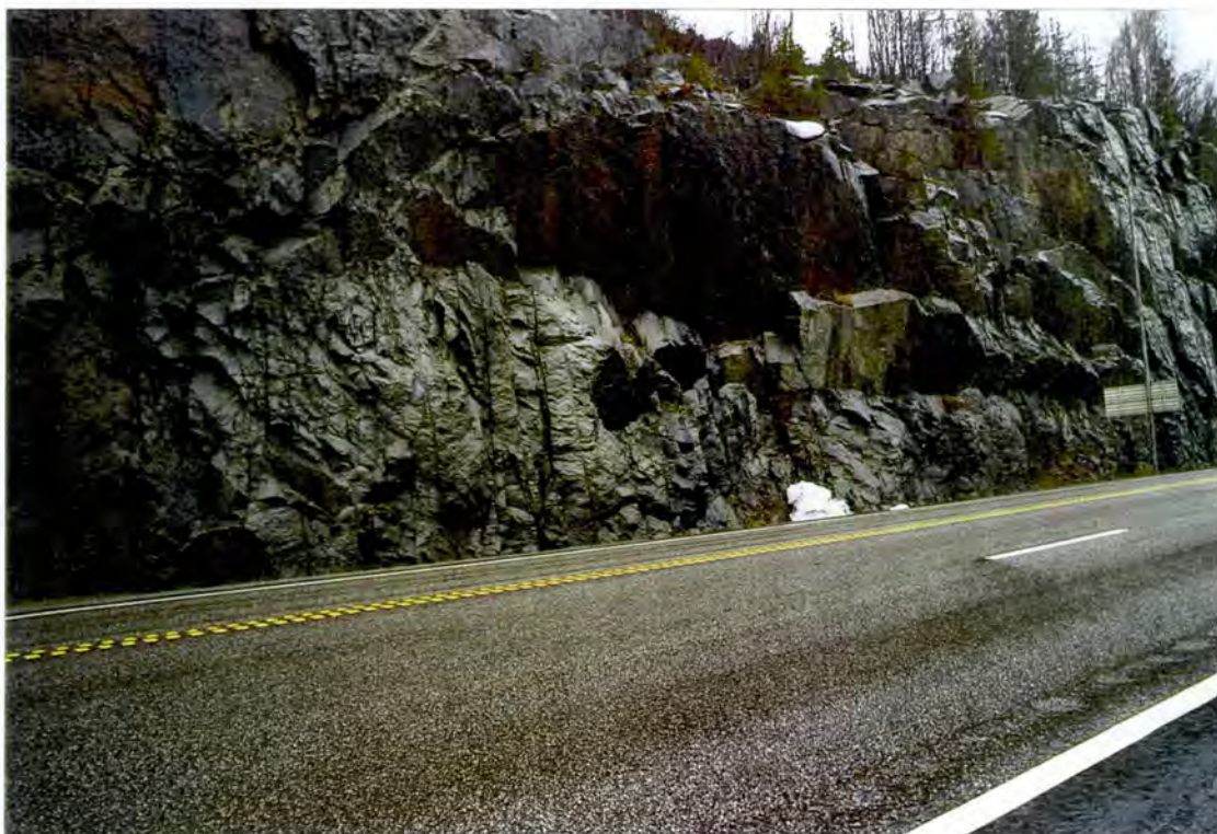
Fig. 3 Markerte sprekker med retning nordvest-sørørst og fall steilt mot sørvest omtrent parallelt med vegen. Sone 2, langs nye E18 like ved Farriseidet. Veggen er ca. 15m høy.
