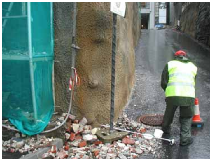
Figur 3. Rester fra oppussing av en bygningsfasade i Bergen. Dette materialet spres lett med overvann over tette flater, spesielt under kraftig regnvær. Her renner overvannet ned i en sandfangskum. Dersom fasaden inneholder PCB, er dette en vesentlig spredningsvei for miljøgiften gjennom et bymiljø.
