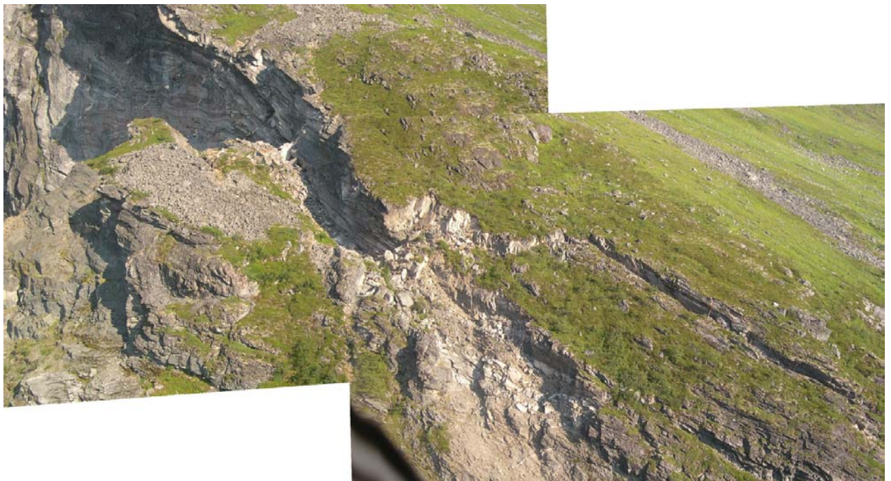
Figur 1. Åkernesremna i den sørvestlige del hvor sprekkene er størst. I området til høyre beveger fjellet seg ca. 3-4 cm pr. år.
